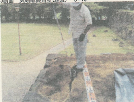
J断面 天端亀裂角度(遠景) \theta=76^\circ
