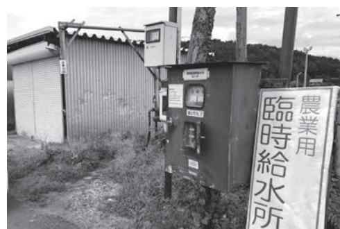
農業用臨時給水所（有尾道路消雪水ポンプ）
