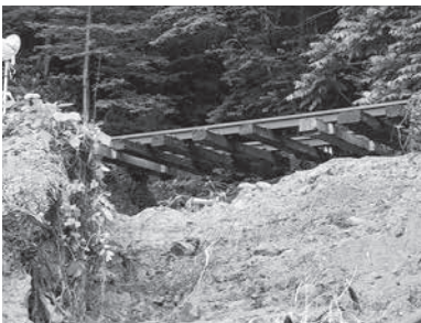
▲市道 2-104 号沿いの JR 飯山線の枕木下が崩落
