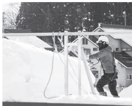
戸狩住宅（市営住宅）での設置状況
