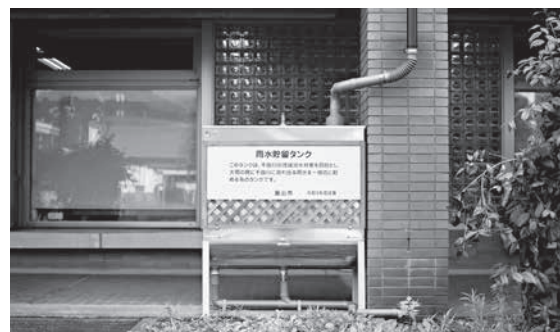
市役所正面の通路に設置した雨水貯留用タンク
