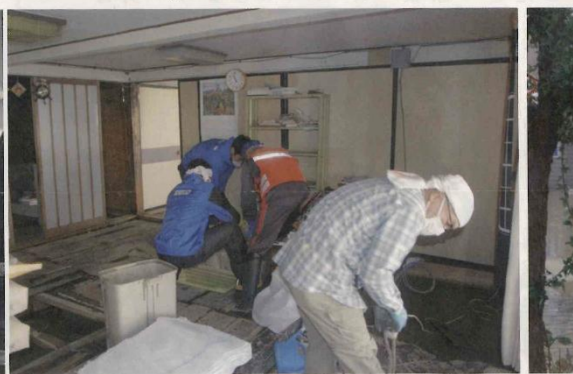
ボランティアによる災害ゴミの撤出作業
