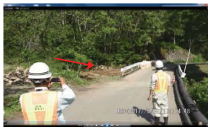
5月22日 土石流発生 ※市道 羽広橋の状況
