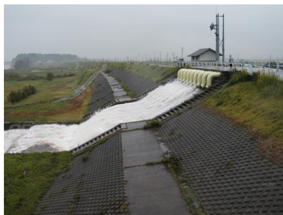
広井川救急排水機場の排水パイプ
