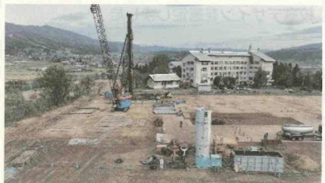
杭を打ち込むための大型重機により建築工事が進められている建設予定地の様子。(11月6日撮影)
