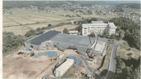
令和7年度2学期からの使用開始に向け工事を進めている城北小学校校舎(令和6年10月撮影)
