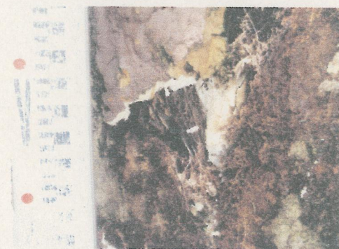
* 南側ウレタン除去内部状態 不定根状況
