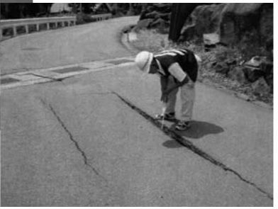
⑦強い揺れの衝撃で、亀裂の入った道路(外様地区)
