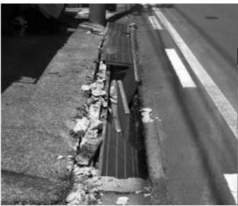
④側溝のふちが破損した水路(飯山地区)
